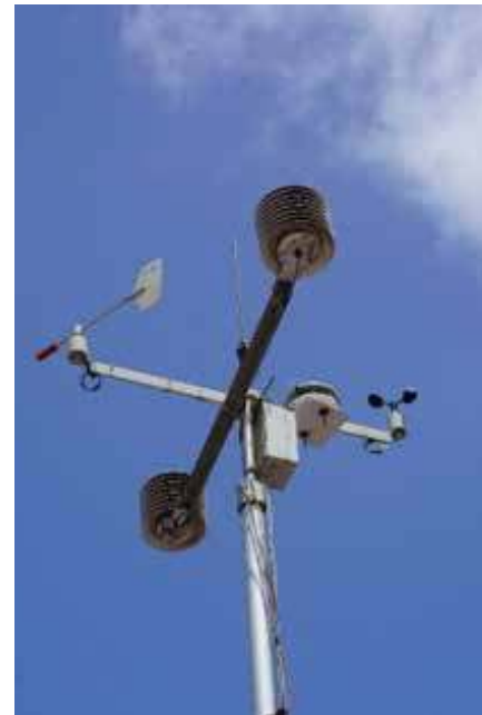
चित्र 2: सीएएक्यूएमएस में स्थापित मौसम विज्ञान सेंसर विहंगम दृष्टि में Figure 2: Overview of meteorological sensors installed at the CAAQMS
